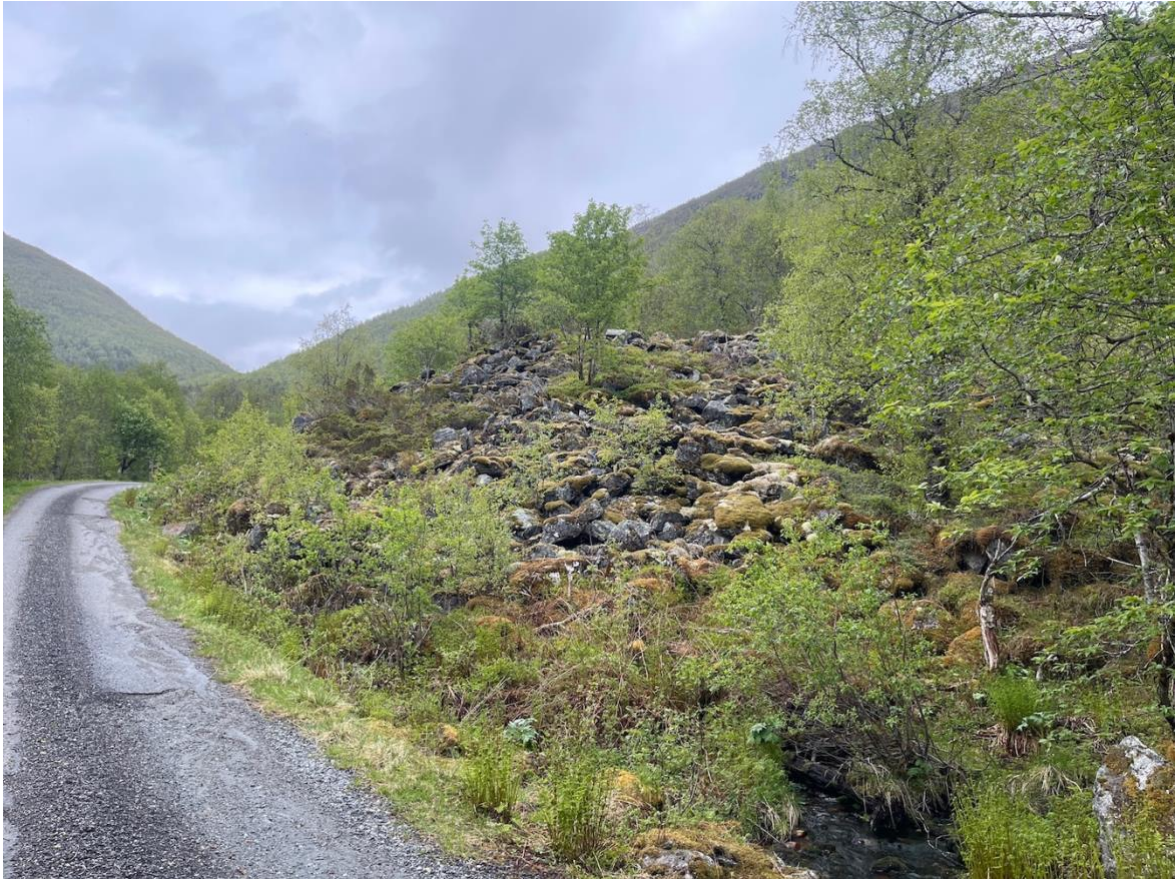
Figur 12. Veien med steinura i overkant. Akkurat på denne strekningen er det ikke så store skader på veien som følge av flommen, da det er en ganske bred kant med vegetasjon mellom veien og elva. Foto: Geir Gaarder
