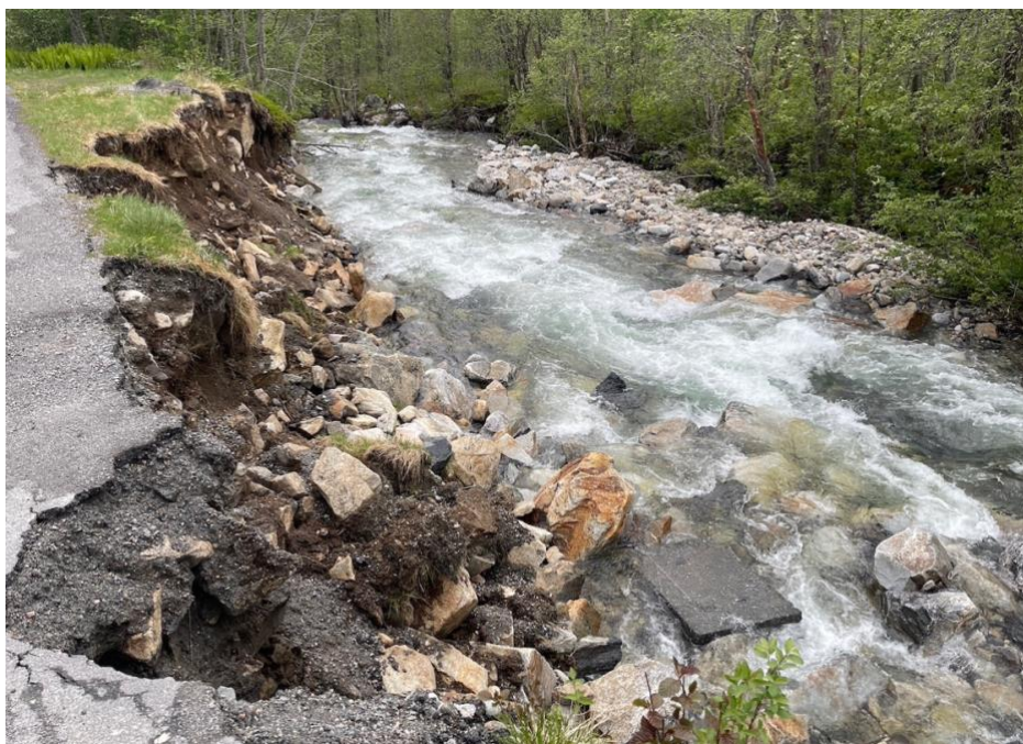
Figur 7. Eksempel på skader på veien og elvebredden ovenfor ferista på Leitet. De grove løsmassene på motsatt elvebredd er sannsynligvis også en følge av flommen. Skogen på motsatt side av elva er dels flommarkskog. Foto: Geir Gaarder
