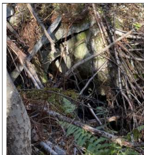
Punkt 1-2: tett med greiner og vegetasjon i innløpet
