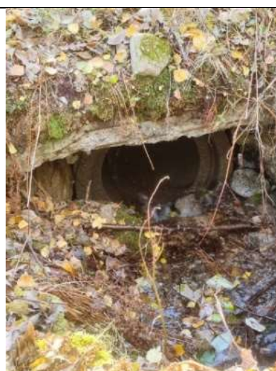
Punkt 1-3 litt massar framfor innløp. Røytet er underdimensjonert
