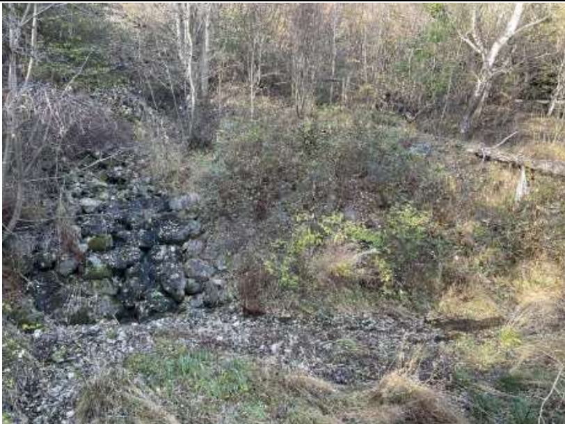
Punkt 6-1: Mykje vegetasjon som blokkerer utløpet.
