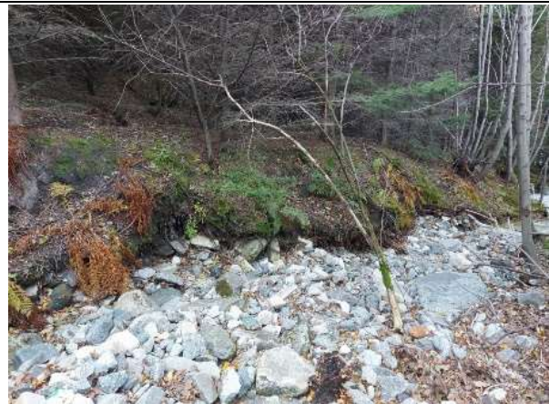
Punkt 8-4 og -6: Erosjon i sidene på bekkeløpet
