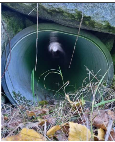
Punkt 2-3: Drivgods og stein i innløp, litt deformert i toppen
