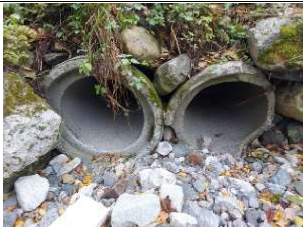
Punkt 8-3: Litt knust rør i utløp
