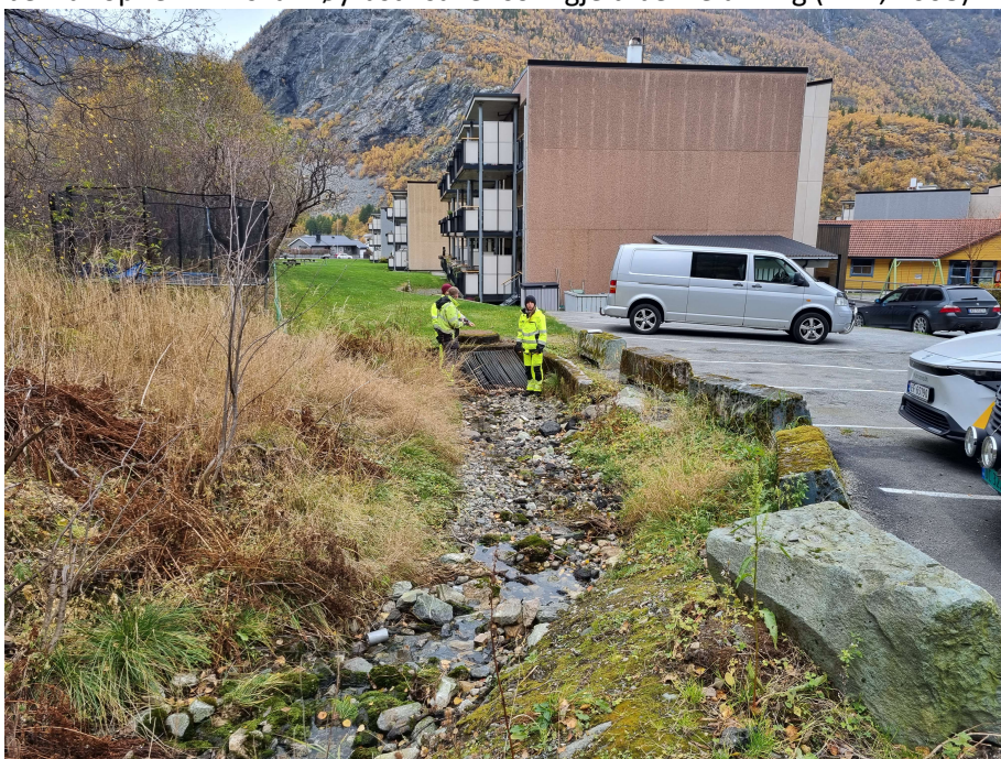
Figur 2-1 Lukka bekkeløp aukar risikoen for vatn på avvegar under ein flaumsituasjon. Det vert råda til å halde bekkar og elver opne heilt til utløp i næraste resipient. Her frå bekkeinntaket ved Årdalsvegen 16B i Øvre Årdal. Bekken renner her frå lukka til utløp i Utle. Bustadane rundt ligger utsett til for overfløyning ved tilstopping eller overskriden kapasitet i inntaket.
