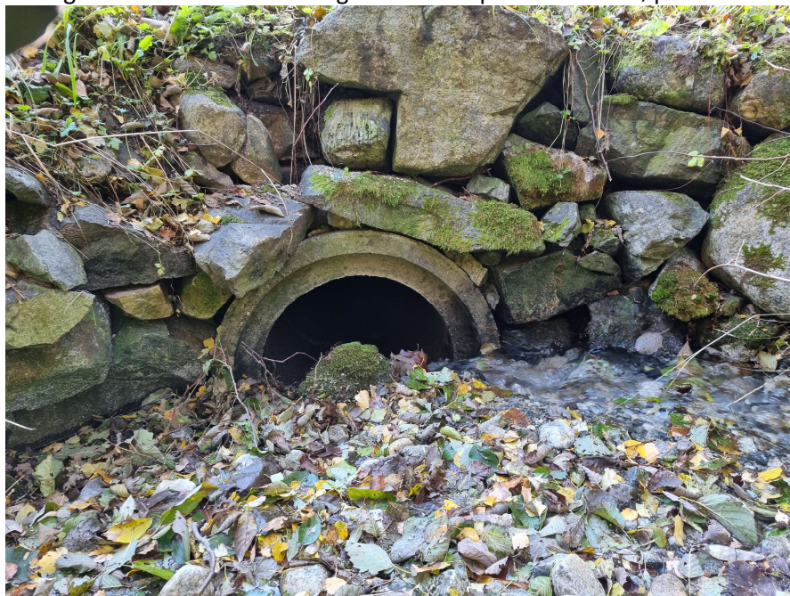
Figur 2-2 Stikkrenne med ein del massar og lauv framfor innløpet. Dette aukar sannsynet for tilstopping under flaum og vatn på avvegar. Biletet er tatt på Seim, i Dalavegen, punkt 3-6.
