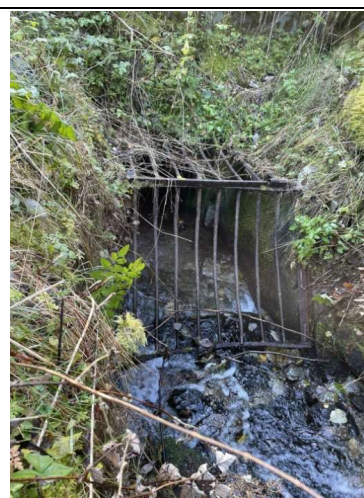
Punkt 2-8: Betydeleg underdimensjonert røyr, og høge hastigheiter
