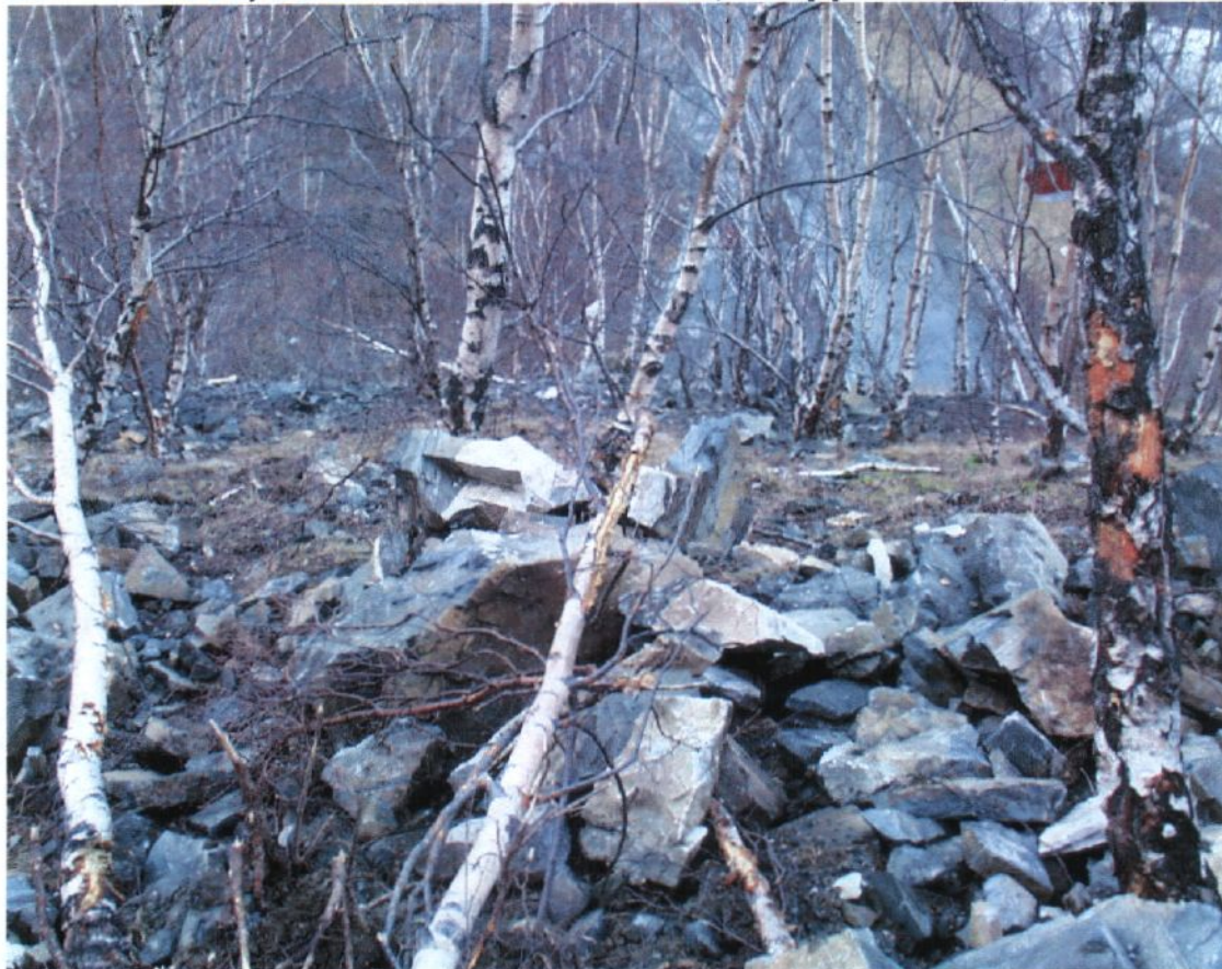
4: Fv. 303, Seimsdaltunnelen aust, steinmassar over tunnelopninga, 13-01-2005
